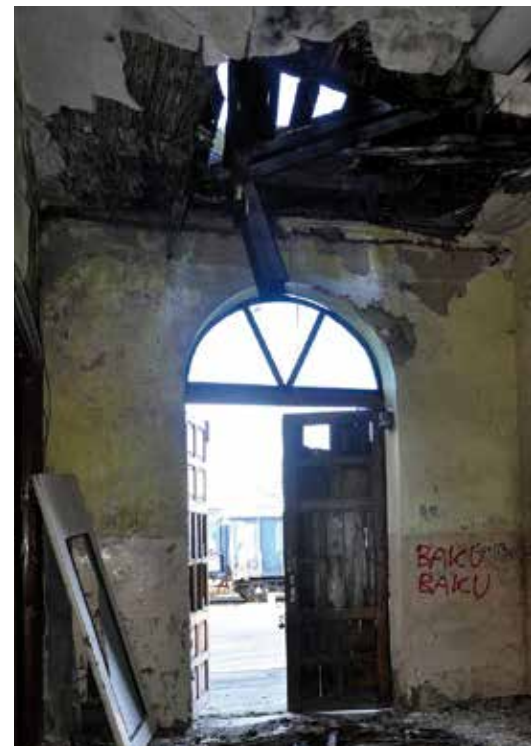
▲ Stan budynku przed remontem był przerażający
